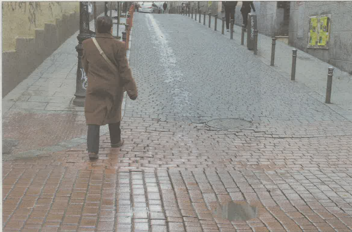
Vista de socavones y firme irregular en una de las calles del céntrico barrio de Malasaña. ÁNGEL NAVARRETE
