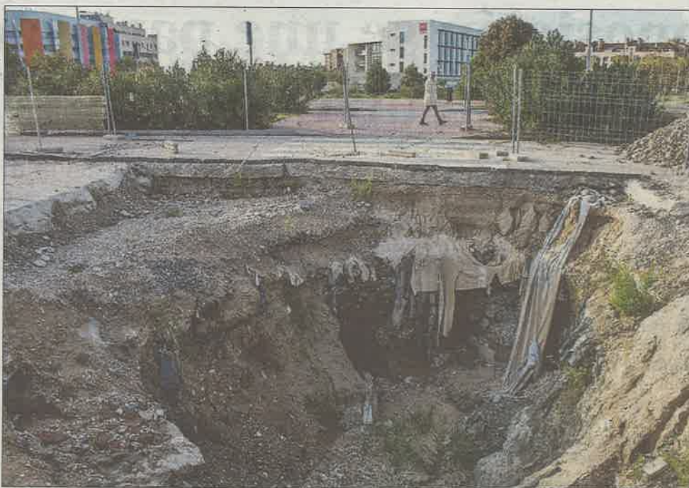
Socavón entre la avenida de la Gavia y la avenida del Cerro Milano. / ALEX ONCIU
