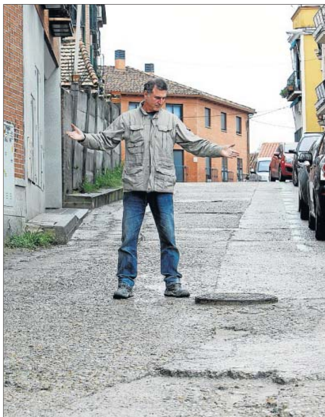
SIN PAVIMENTO NI ACERAS EN FUENCARRAL. El entorno de la calle Columbreres «no se ha arreglado desde que se edificó el barrio en los setenta», dice José. «Nos tienen abandonados», se queja Francisco.
