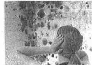
Problemas de humedades por condensación
