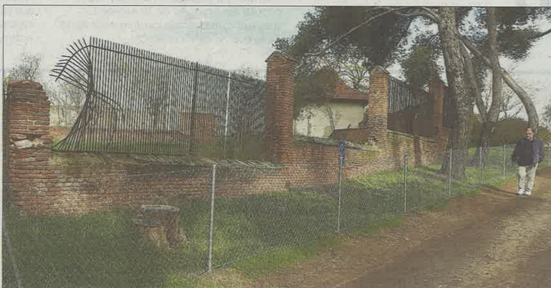
Desperfectos en las verjas de la Quinta de Torre Arias. / JAIME VILLANUEVA
