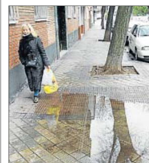
VALLECAS, INTRANSITABLE. Muchas aceras de Villa de Vallecas están hundidas y con las losetas resquebrajadas, como la que aparece en la foto, en la calle Felipe Álvarez.
