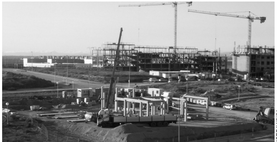
La subestación se levanta actualmente cerca de dos colegios, un hospital y un centro de mayores.
