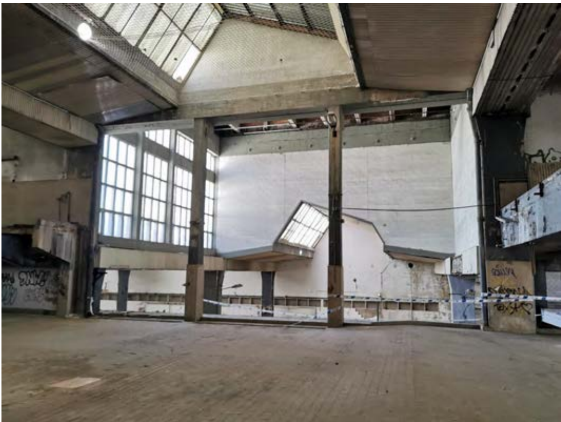
Figura A22. Vista desde lado opuesto a la anterior. Falta cielo raso en cubierta lucernario. Autor. 2023/04/04.
