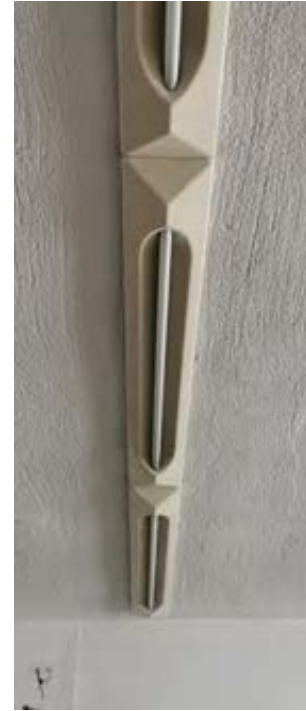
Figura A38, Luminaria fluorescente de plástico existente en techos de oficinas. Autor. 2023/04/04.
