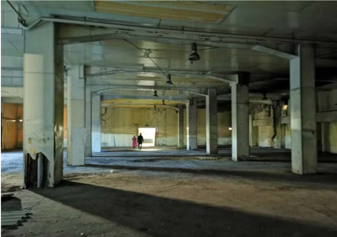
Figura A29. Almacén bajo planta de tratamientos. Fue supuestamente demolida en fecha indeterminada la entreplanta de almacén que figura en los planos de sección. Autor. 2023/04/04.
