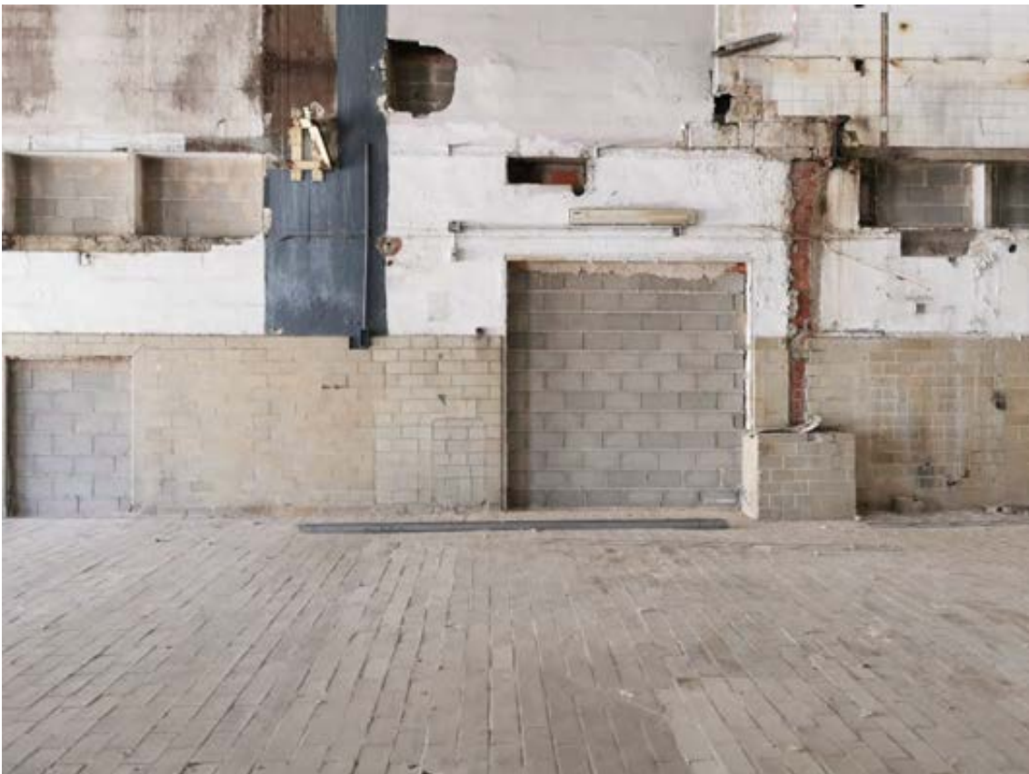
Figura A28. Estado de acabados en nave producción, paramento este. Autor. 2023/04/04.
