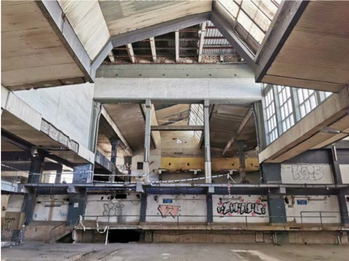
Figura A21. Vista desde nave de producción hacia torre de esterilización. Falta viga en cubierta de la torre. Autor. 2023/04/04.
