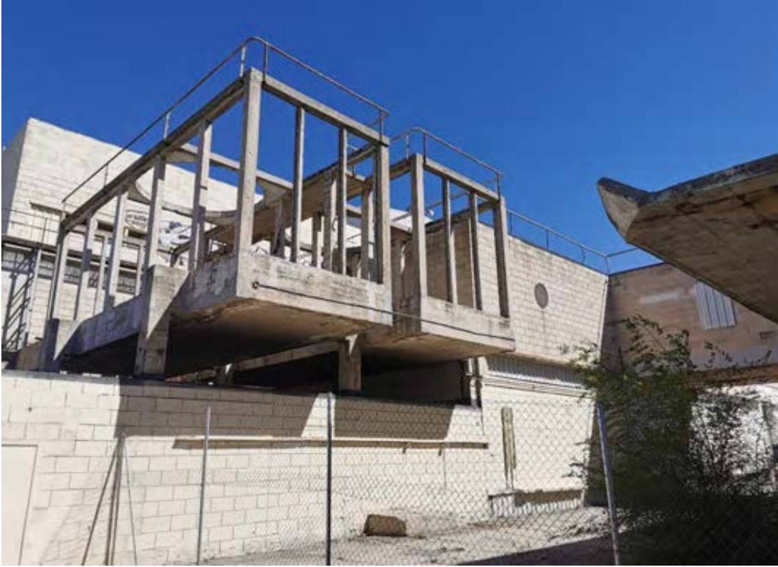
Figura A40, Estructura de equipos de refrigeración. Originalmente revestidos con bloques en los laterales. Autor. 2023/04/04.
