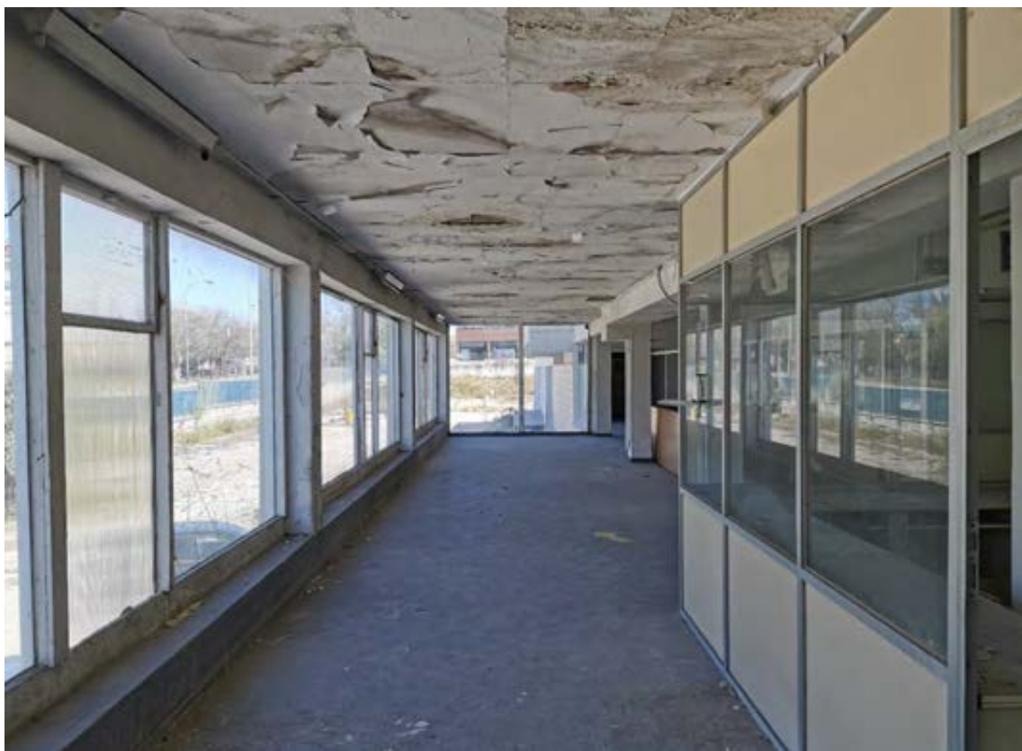
Figura A32. Galería de distribución en planta alta. Mampara de partición instalada posteriormente. Autor. 2023/04/04.
