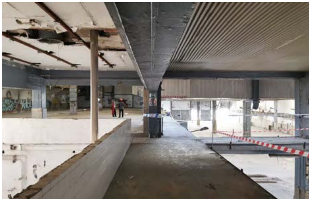
Figura A20. Vista desde el eje medianero entre naves. Cielo raso ausente en zona nave tratamiento (izda) y aislamiento deteriorado. Autor. 2023/04/04.
