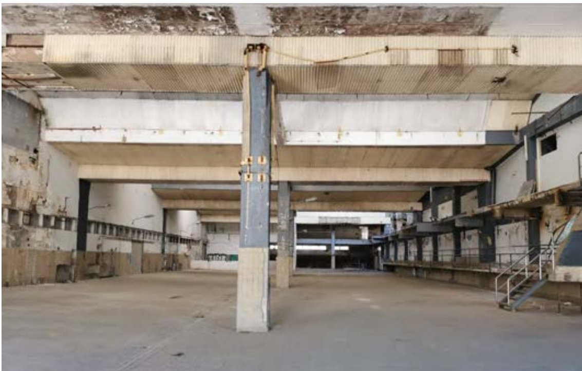
Figura 13. Interior de nave de lavado y llenado. Ausencia de barandilla superior en pasarela y de escaleras de pasarela inferior a suelo de la nave. Autor. 2023/04/04.
