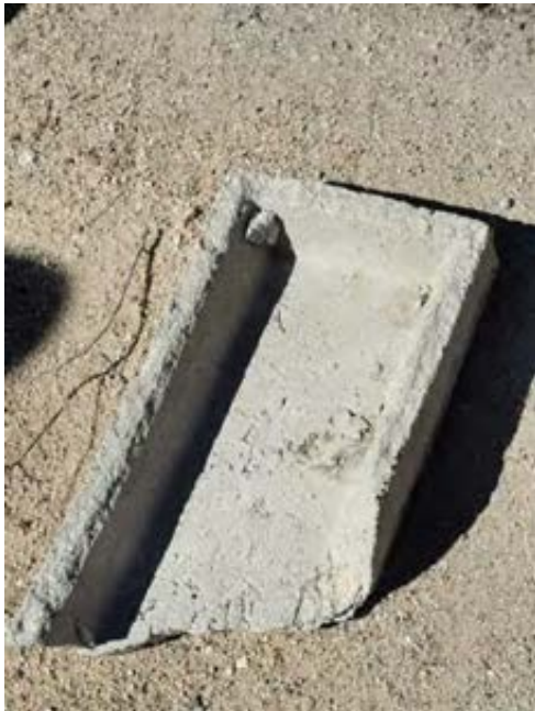
Figura A55. Pieza de revestimiento incompleta por rotura. Cara interior. Autor. 2023/04/04.
