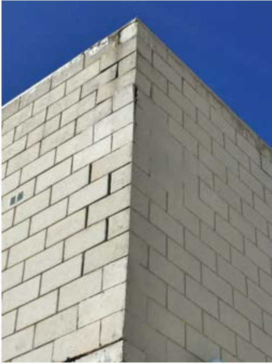
Figura A44. Desperfectos y roturas de recubrimiento en esquina, estado actual. Autor. 2023/04/04.
