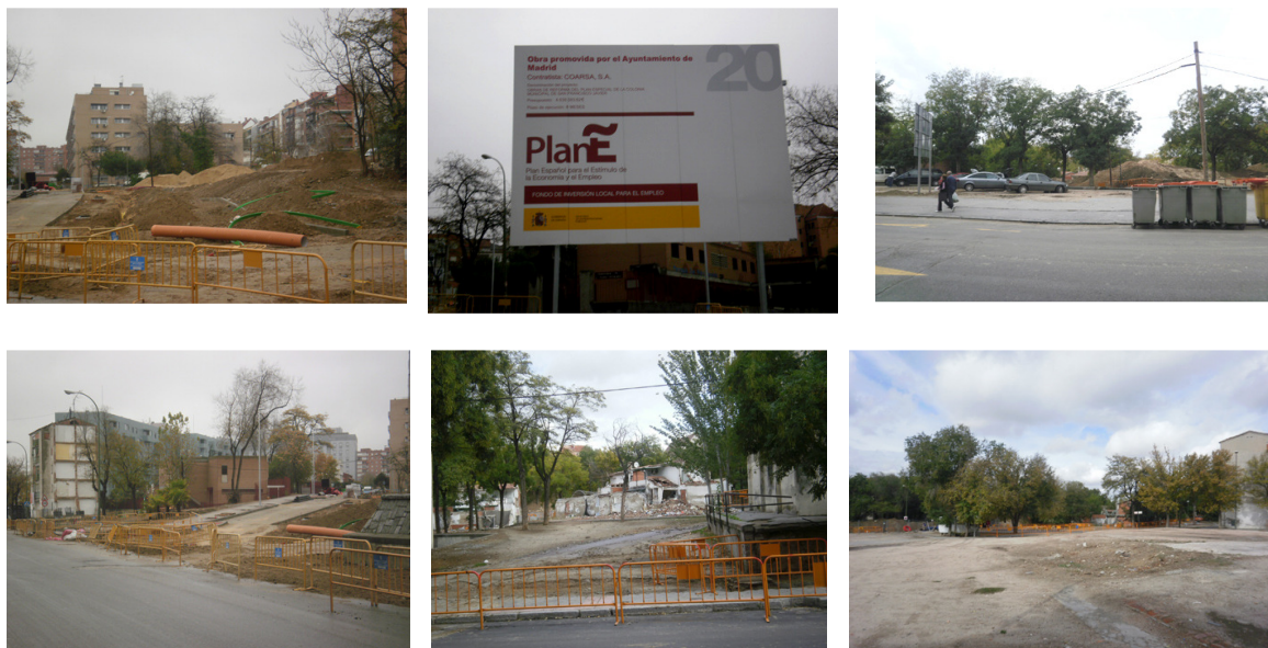
Obras de urbanización del Plan Parcial de Reforma Interior de las colonias San Francisco Javier y Nuestra Señora de los Ángeles
