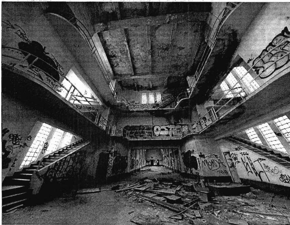
Foto tomada desde el interior de la primera galería. / DANIEL FERNÁNDEZ PARRA
